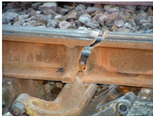
FIGURE 1.11 – Rupture d'un rail sur la ligne D du RER, de au gel en Octobre 2003
