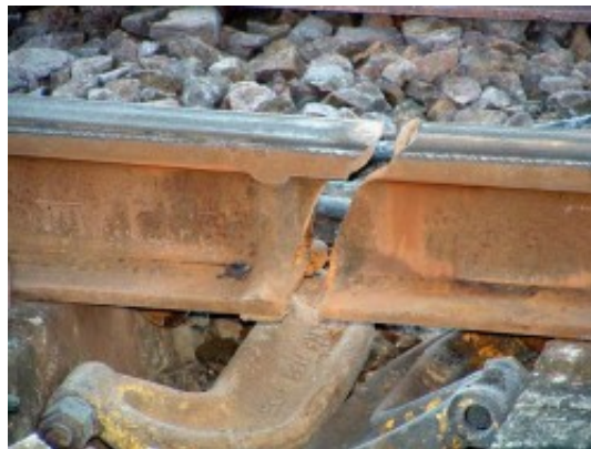
FIGURE 1.11 – Rupture d'un rail sur la ligne D du RER, de au gel en Octobre 2003
