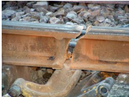
FIGURE 2.11 – Rupture d’un rail sur la ligne D du RER, de au gel en Octobre 2003
