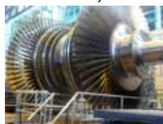
Turbine à vapeur
