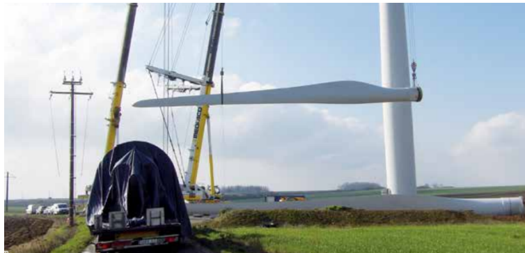
FIGURE 4 – Remplacement d’un roulement sur une éolienne dans les environs de Poitiers (source : 7 à Poitiers, n° 299, 2 au 8 mars 2016, crédit : Sergies / Le 7).
